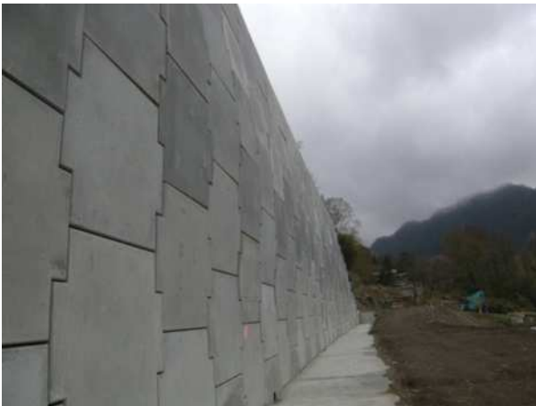
■写真1：撤去前（2018年1月） 壁面の一部にはらみが生じている
